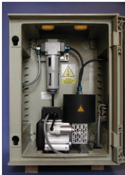
Obr. 3. Čerpací jednotka horkých a vlhkých plynů z míst s podtlakem
